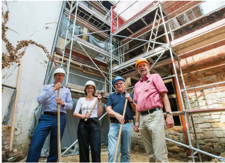
Matthias Gericke, Kerstin Langenheim, Hartmut Krämer und Wolfgang Brumund beim ersten Spatenstich eines Fachwerkhauses.
